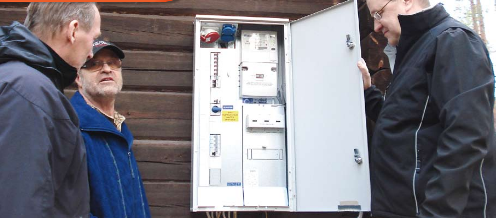
Alueteknikko Kaarlo Pöyliö (vas.), Matti Wallén ja verkkopäällikkö Jukka Ojala vilkaisivat sähkökaappiin ja totesivat sen olevan asianmukaisessa kunnossa.
